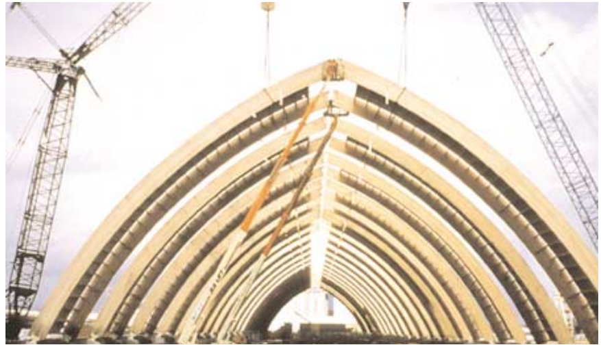
俄勒冈州波特兰市21925平方米的碳酸钾储运大楼采用了APA EWS胶合木拱形设计。
